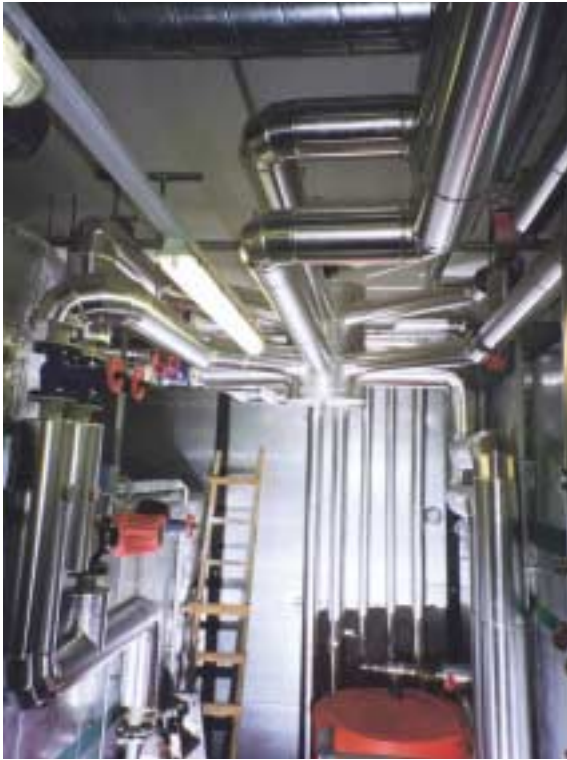
Bauhof, Linz (A) 700 kW
