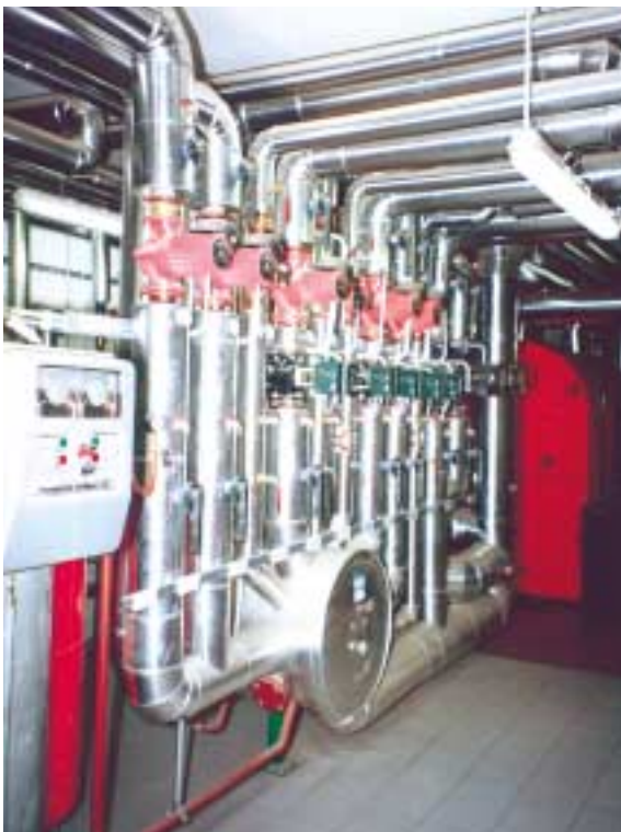
Hauptschule, St. Michael (A) 1050 kW
