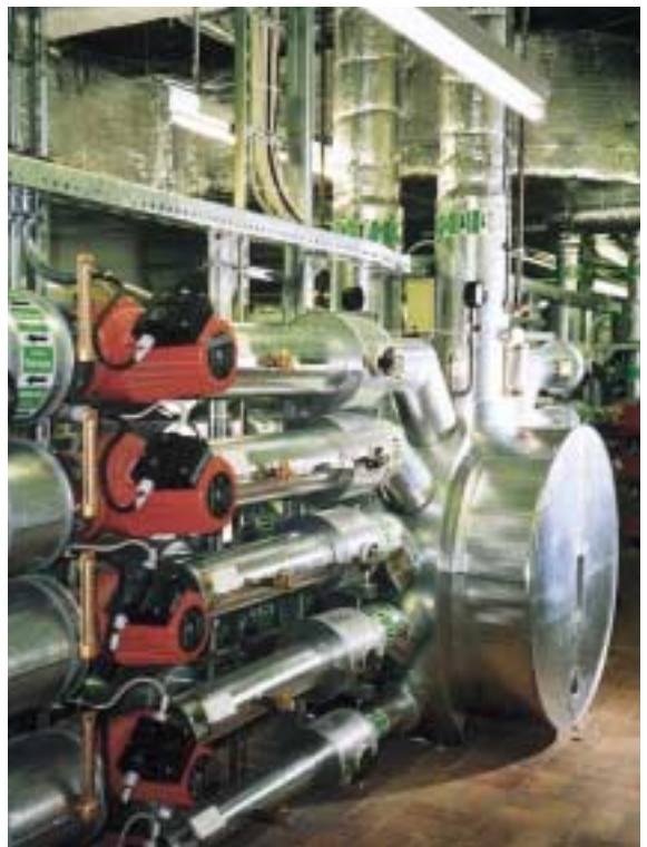
Krankenhaus, Nürtingen (D) 3000 kW
