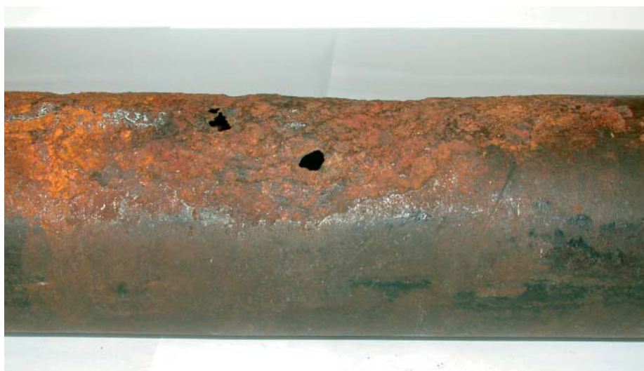
Коррозия дымовой трубы. Коррозия вызвана воздействием бактерий.
